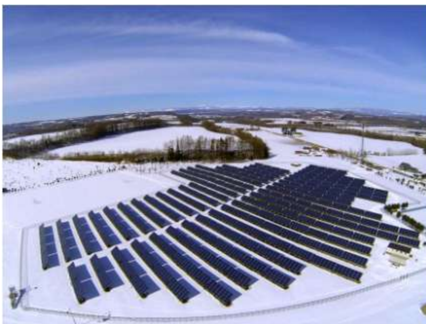
本別太陽の丘ソーラー発電所
