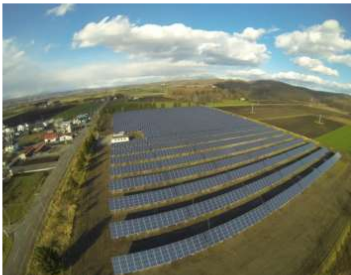
ワインの里池田ソーラー発電所
