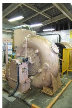
写真2 秋の川発電所水車発電機
