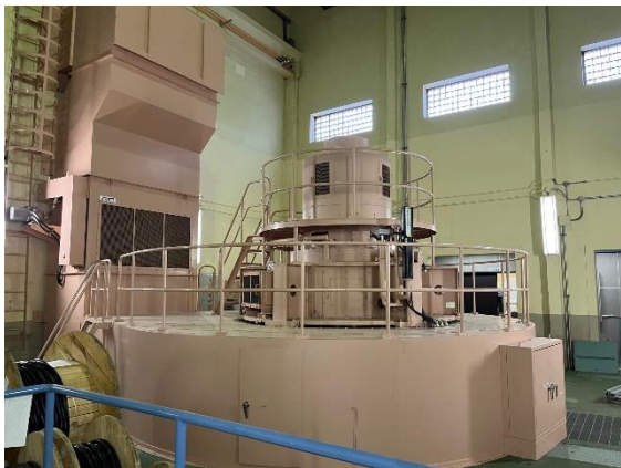
【既設発電機（今回更新）】
