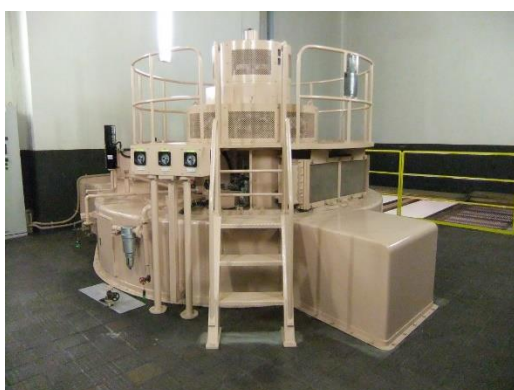
【既設発電機（今回更新）】
